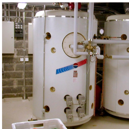
Kuva 5. Lauhdelämmön suuri hyötykäyttöaste suuressa osassa hallin lämmitystarpeesta edellyttää lauhde ja tulistuslämmön varastointia varaajissa. Lämmön varastoinnin tilantarpeen lisäys on suuruusluokkaa 20 \pm 5 \text{ m}^2 .
